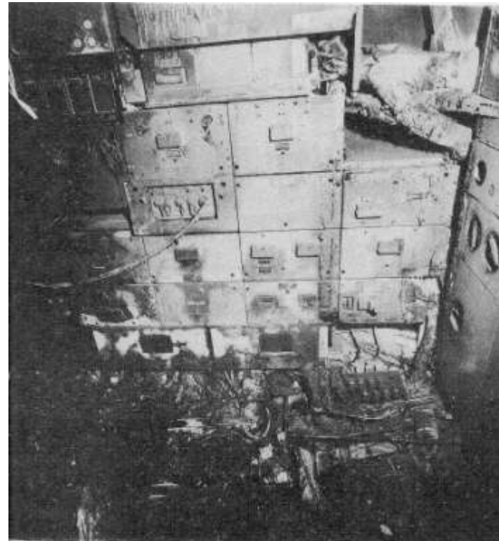
Right Hand Section Lower Equip Bay
